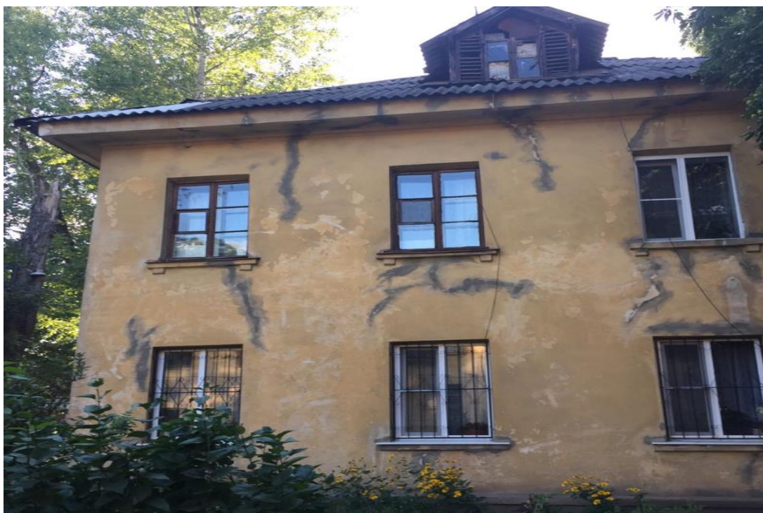
Рис. 2. Характерное раскрытие трещин в деформированном при просадке фундамента и крене несущих стен здания, с концентрацией напряжений в зонах оконных проёмов
