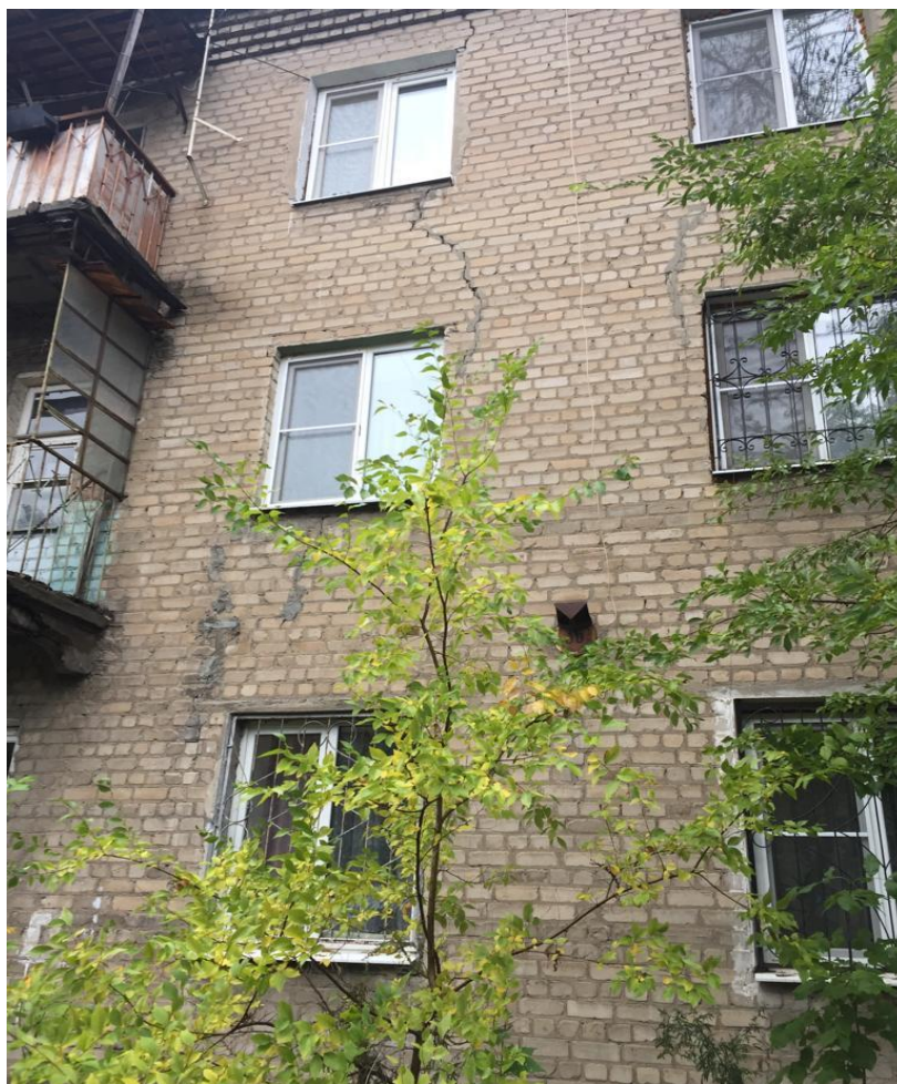
Рис. 3. Четырёхэтажное жилое типовое здание 1960 года постройки, с частичной просадкой фундамента и трещинообразованием на всю высоту здания от фундамента до кровли, с раскрытием трещин до 40 мм в ограниченно-работоспособном состоянии
