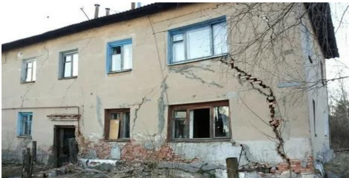
Рис. 1. Деформационное разрушение жилого дома типовой серии при просадке фундамента при гидрогеологическом нарушении грунтового основания
